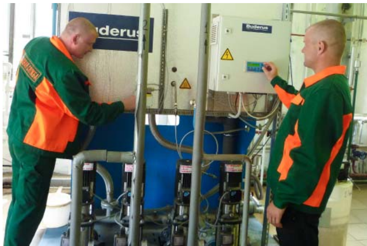
Слесарь ЭиРГО газовой службы Сергей Костюченко и слесарь КИПиА газовой службы Андрей Бильданов
